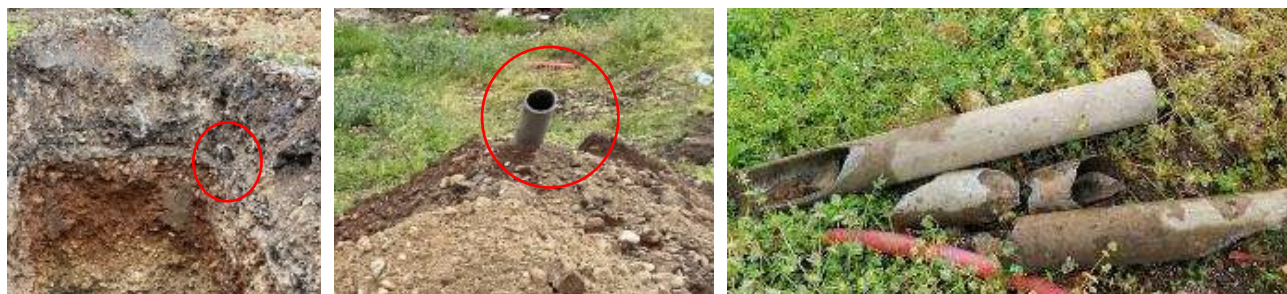
Figure 7 : Tuyaux potentiellement amiante au niveau des sondages GO3 et GO4.
