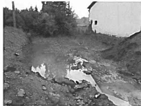
Eaux superficielles stagnantes en fond de fouille
