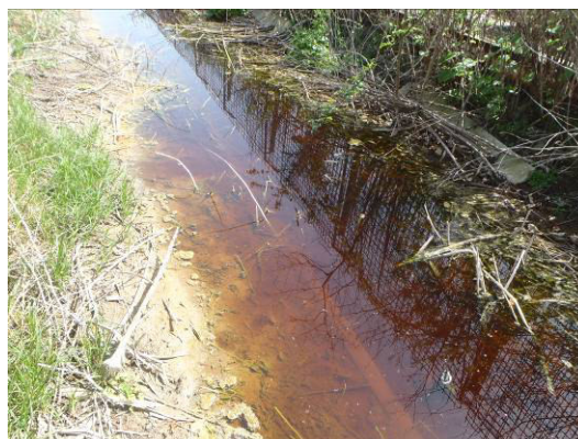
Figure 4. Tranchée remplie d'eau en limite Nord du site
