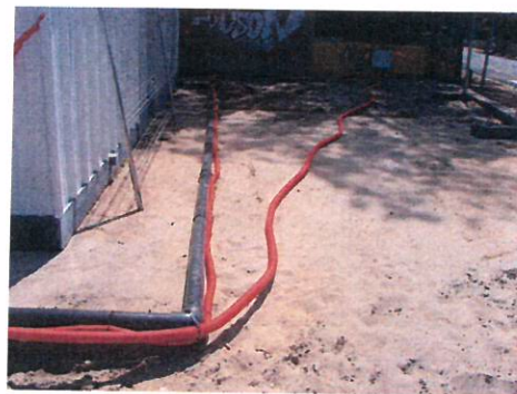
photo 2 : réseau de pompage
