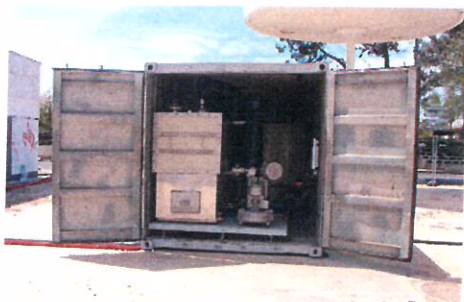
photo 1 : conteneur ( stripper et soufflante)
