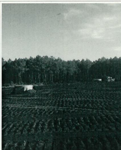
Vue sur haut du dôme fini (couche de terre végétale et puits de biogaz installés)
