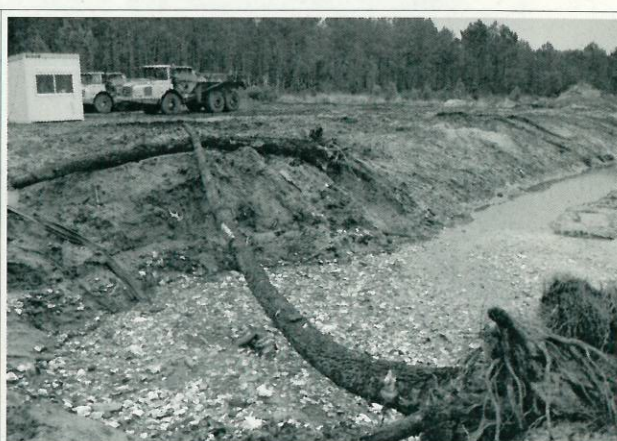
Vue sur déchets flottants dans le coin nord-ouest de la lagune
