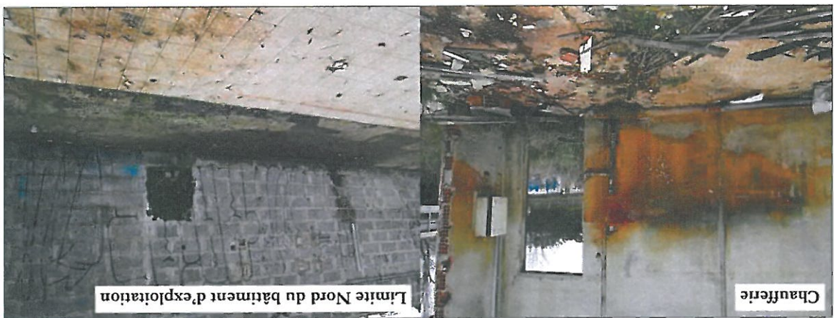
Figure n°37 : Traces de corrosions métalliques. (14.150.RA.001.01.Fig037)
