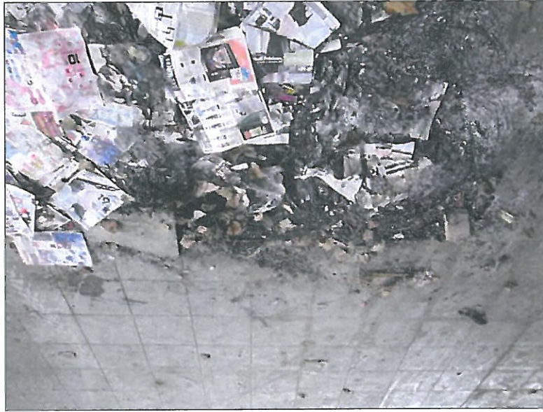
Figure n°22 : Brûlages en partie Ouest du bâtiment d'exploitation - Téréo, novembre 2014.
