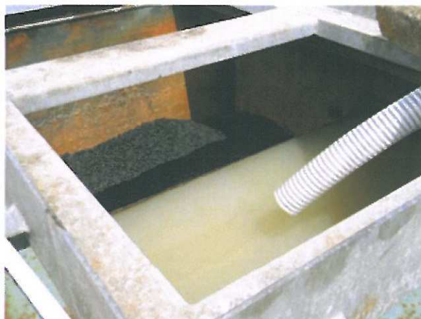
17/06/08 : Vue de l'intérieur du décanteur et du filtre à charbon actif
